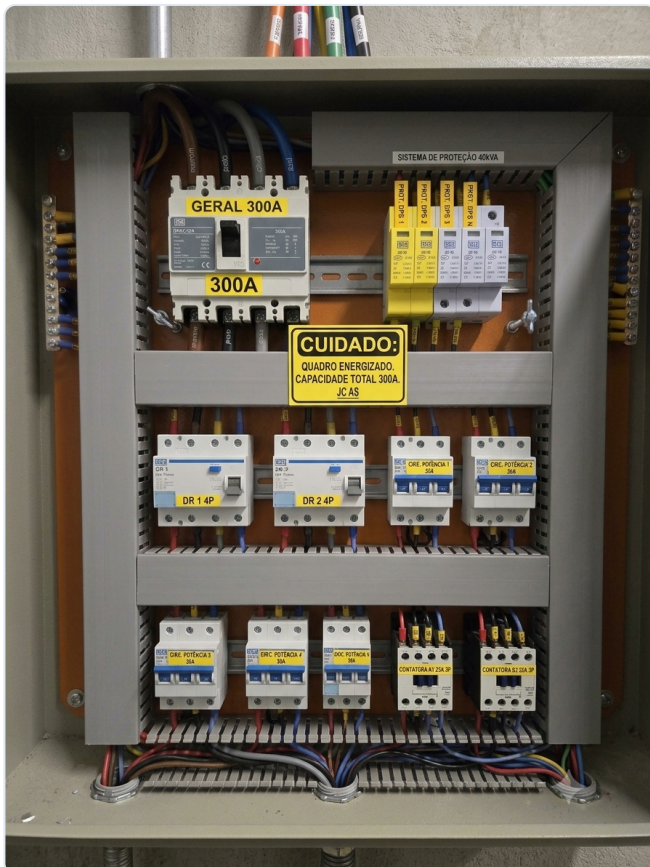
Quadro Geral de Distribuição (QGDF)
