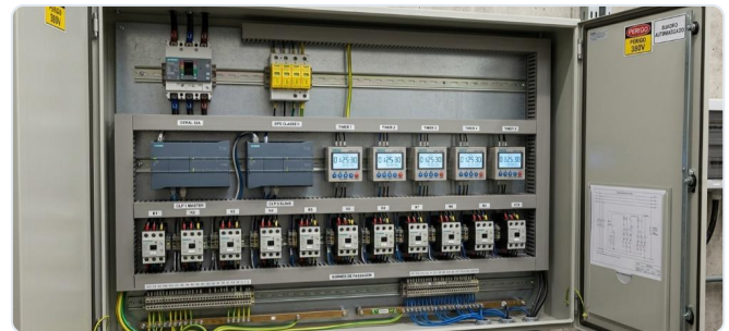
Painel de Comando e Automação Industrial
