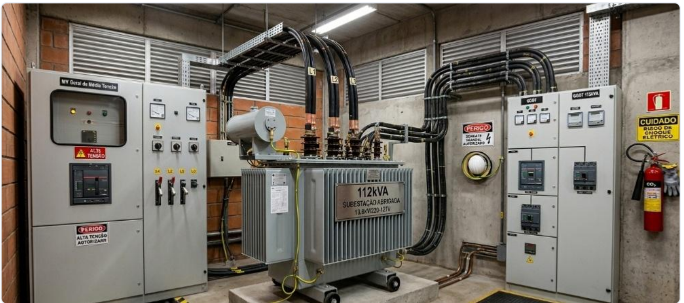
Infraestrutura real de uma Subestação Abrigada de 112kVA (13.8kV / 220-127V), evidenciando o transformador de potência, painéis de proteção e o rigoroso padrão de sinalização de segurança ativa.
